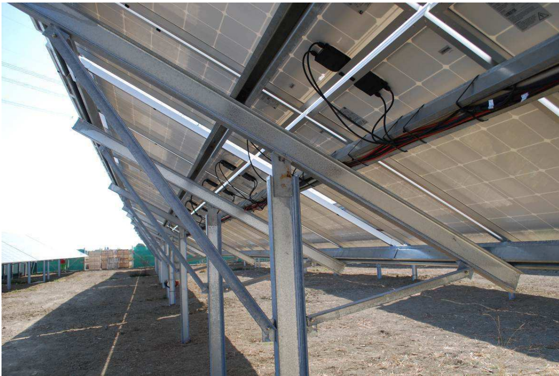
Particolare struttura di sostegno dei moduli fotovoltaici
